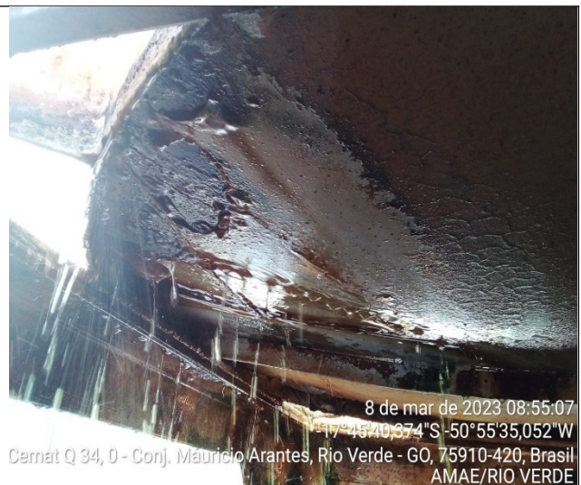
Autor: AMAE Descrição: REL Miriam Resende – Processo corrosivo na base do reservatório, onde consta o vazamento.
