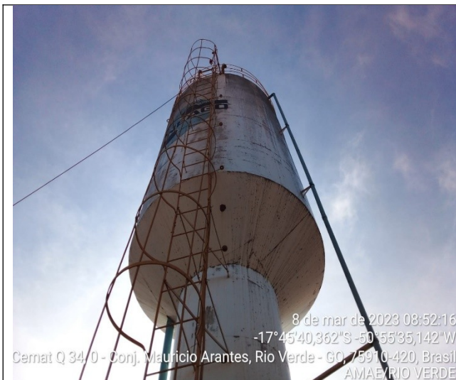
Autor: AMAE Descrição: REL Miriam Resende – Processo corrosivo no reservatório.
