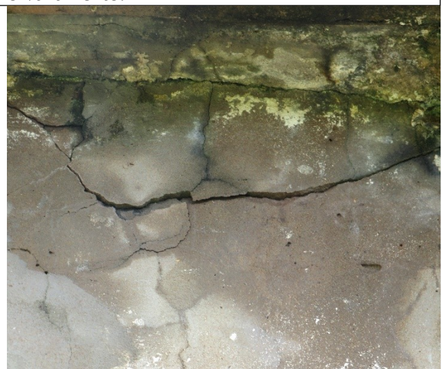
Autor: AMAE Descrição: RST Miriam Resende – Rachaduras estruturais na parede do reservatório.
