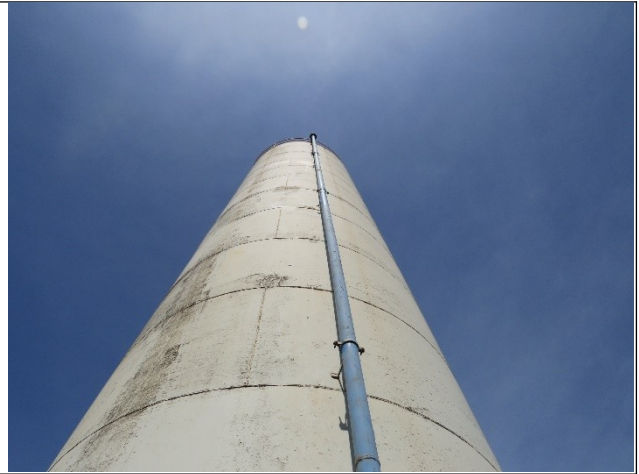
Autor: AMAE Descrição: REL Girassóis – Necessário a realização de pintura na parede externa do reservatório
