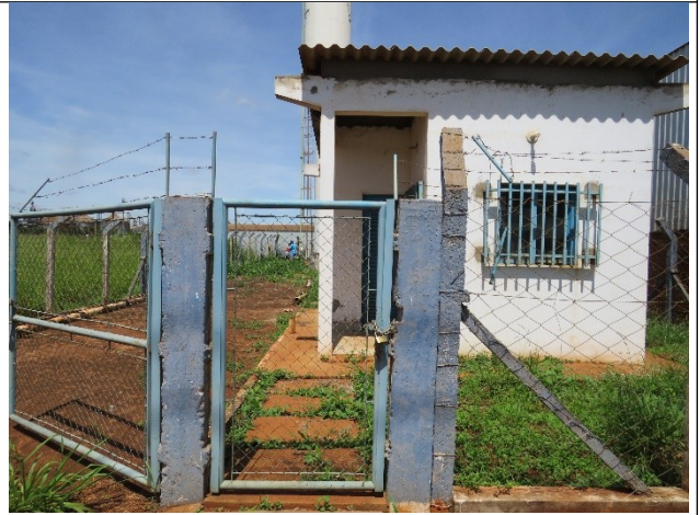
Autor: AMAE Descrição: REL Porto Seguro – Local sem placa de identificação e com condições de limpeza inadequadas.
