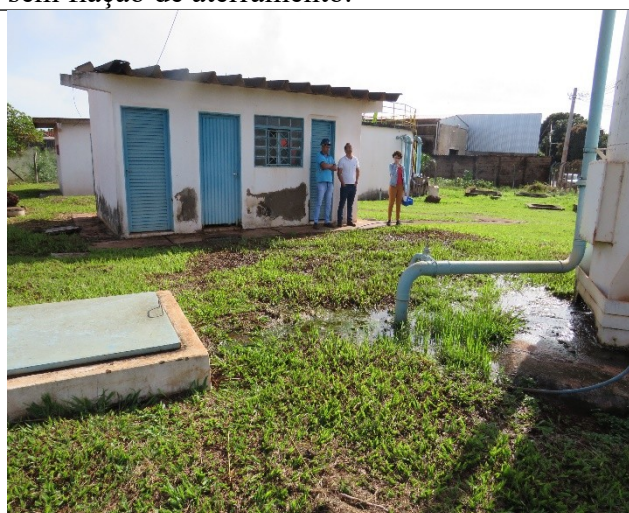
Autor: AMAE Descrição: REL Miriam Resende – Vazamento de grande porte na base do reservatório.
