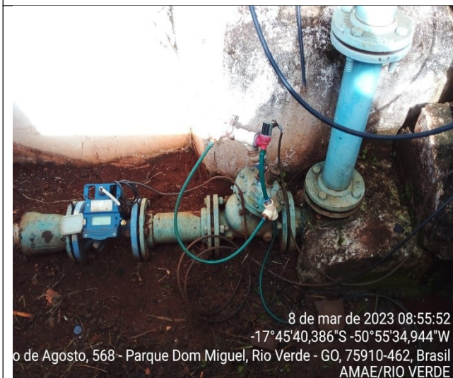
Autor: AMAE Descrição: REL Miriam Resende – Vazamento de água no solenoide.
