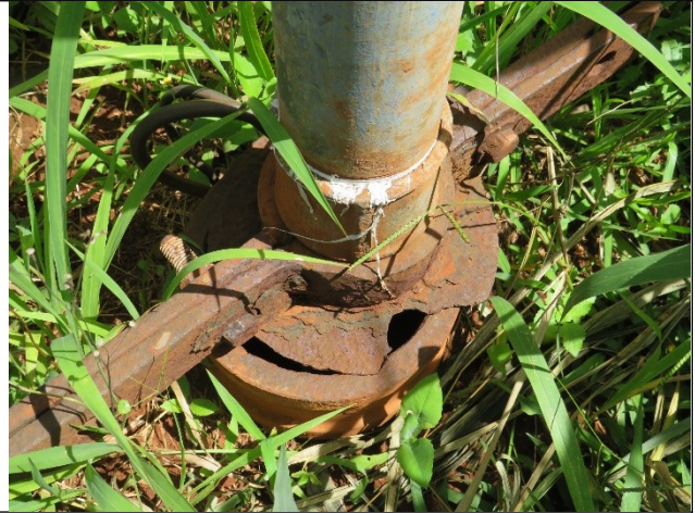
Autor: AMAE Descrição: REL Girassóis – Tampa do poço com corrosão.
