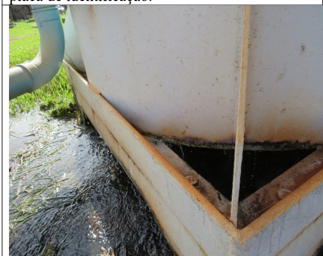
Autor: AMAE Descrição: REL Miriam Resende – Vazamento de grande porte na base do reservatório.
