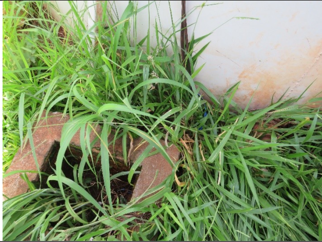
Autor: AMAE Descrição: REL Girassóis – Caixas de passagem desativadas sem tampa.
