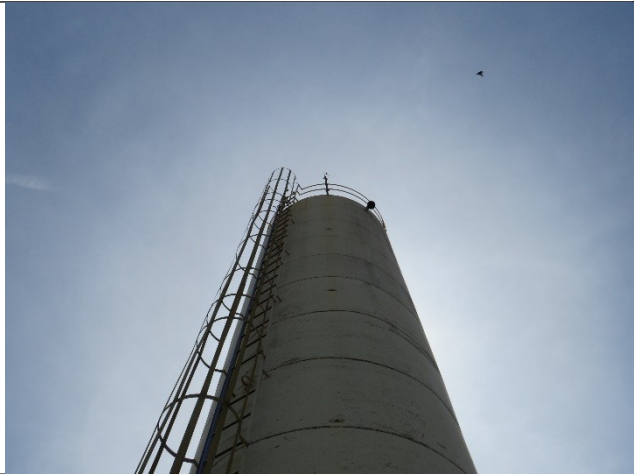
Autor: AMAE Descrição: REL Girassóis – Reservatório sem sinalização noturna e sem fio de aterramento do para-raios.
